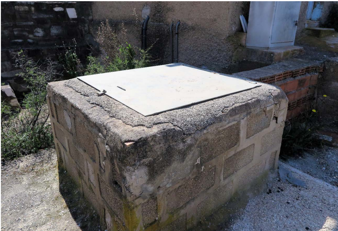
Caseta de recubrimiento del pozo
